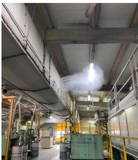
Système de vaporisation d'eau dans le peignage de Terre de Lin
